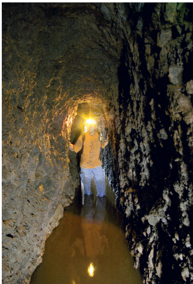
Tramo inundado, sin entibar, entre el final de la rampa y la estación de muestreo nº 2. (Foto: O. Fernández)
