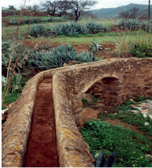
Acequia en Valsequillo, elevada sobre un puente. Foto cedida por Francisco Suarez Moreno.
