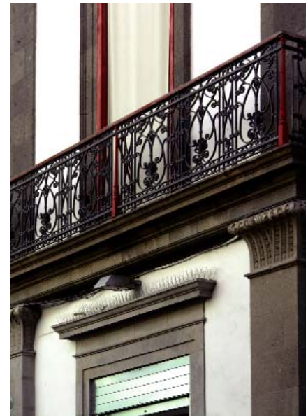
Detalle del frontis de la Casa Miller en la Calle Mayor de Triana. Las Palmas de Gran Canaria.
