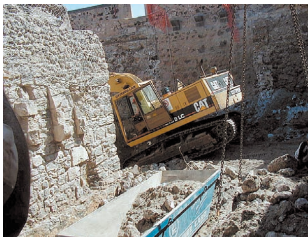
■ Vaciado del edificio por medios mecánicos desde la cubierta del Castillo. Septiembre 2001
