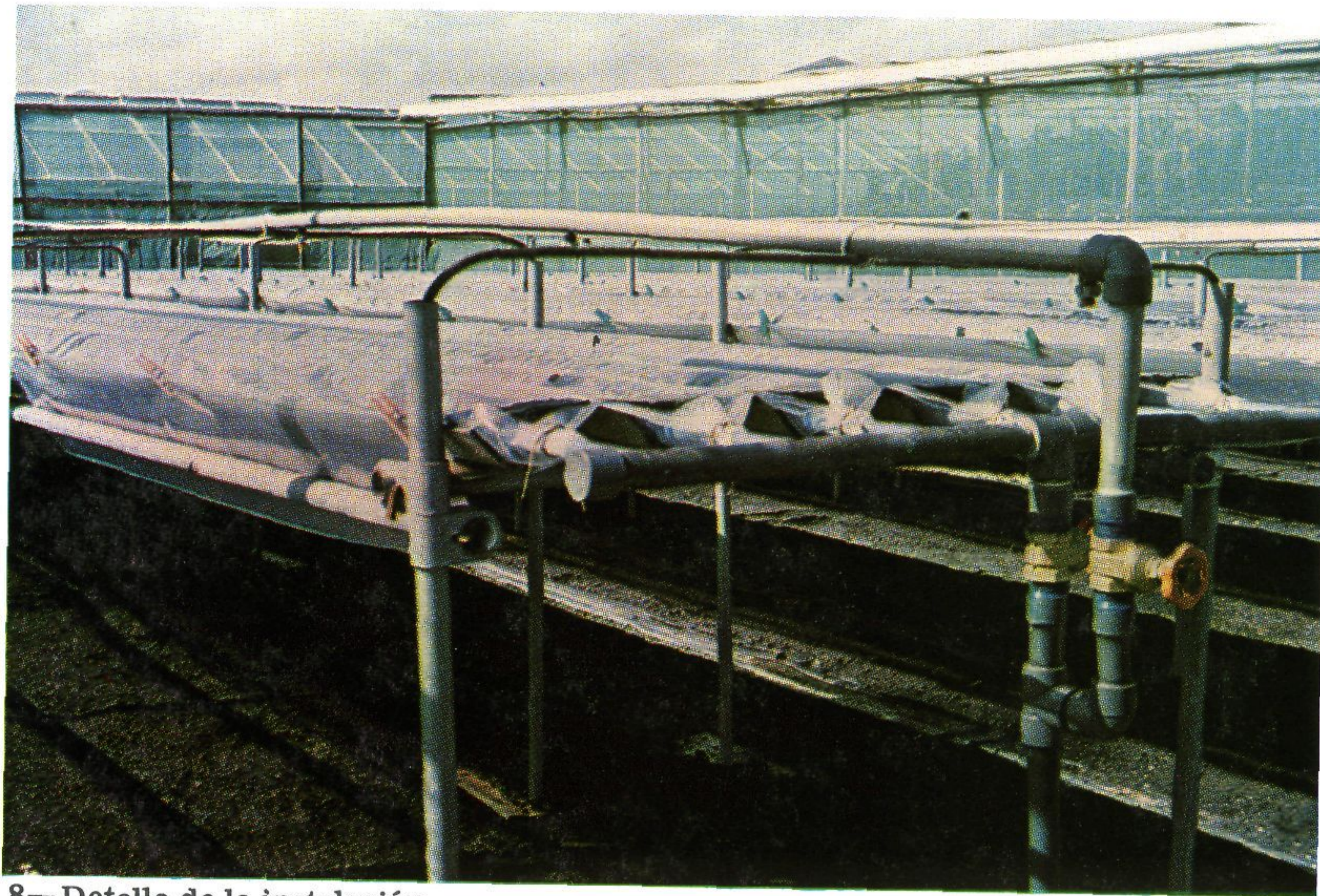
8— Detalle de la instalación.
