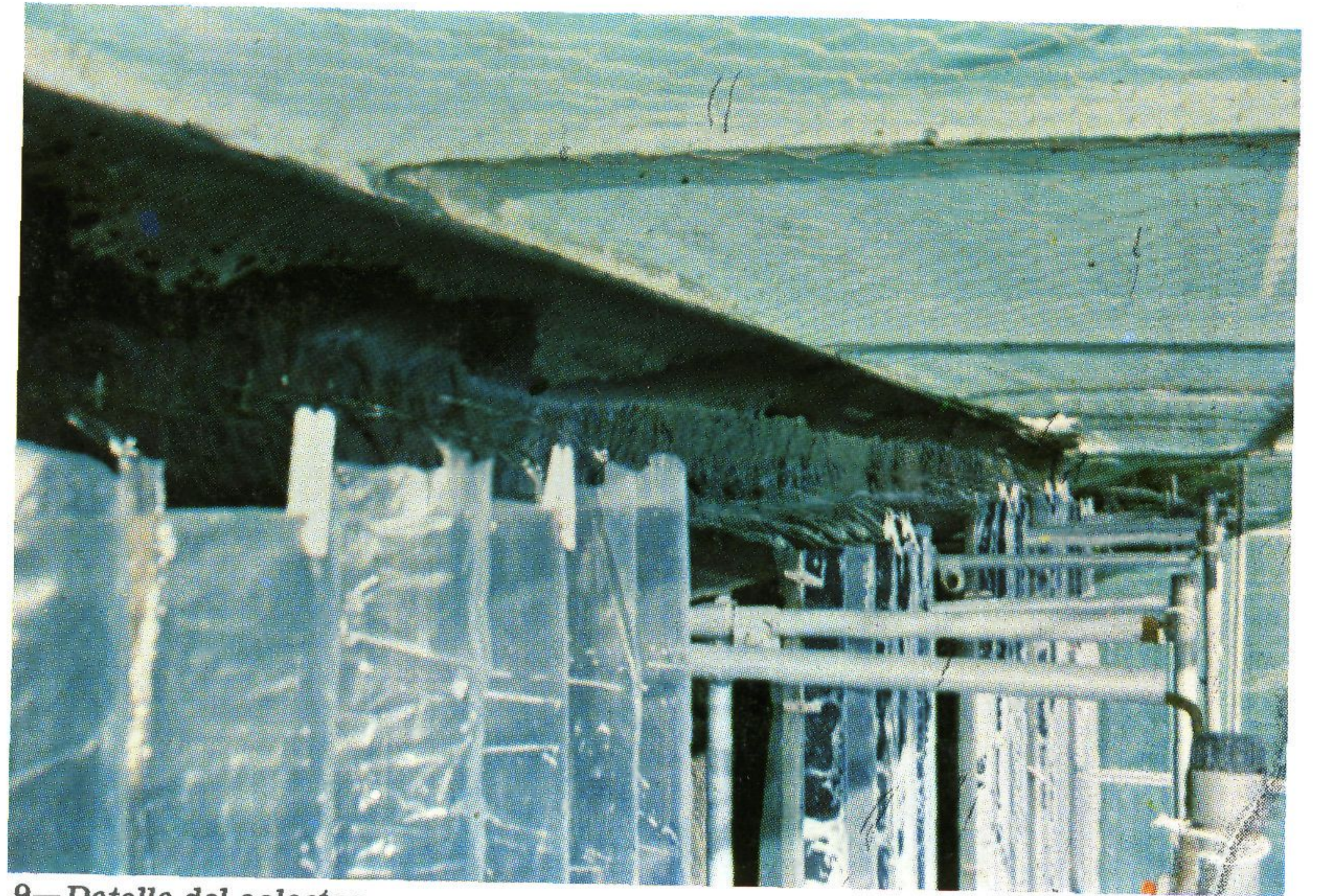
9— Detalle del colector.
