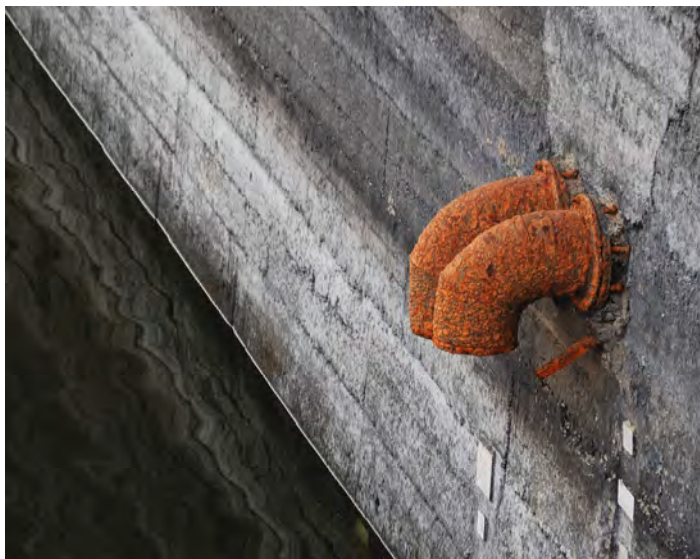
Tuberías de las tomas de agua de la Galería 1 (Foto JG)
