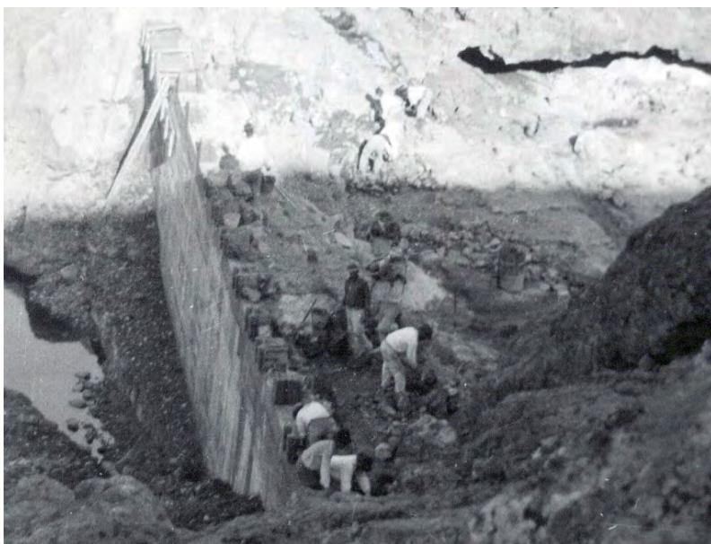
Trabajando en el muro ( obras de la primera etapa ) (Foto Comunidad de Regantes de la Presa de la Cueva de las Niñas)
