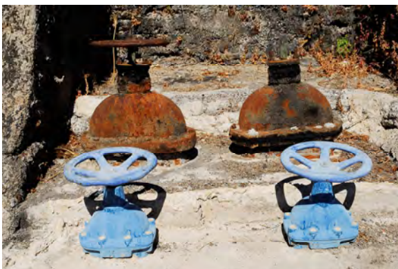
Tomas de agua de la Galería 1 (Foto JG)
