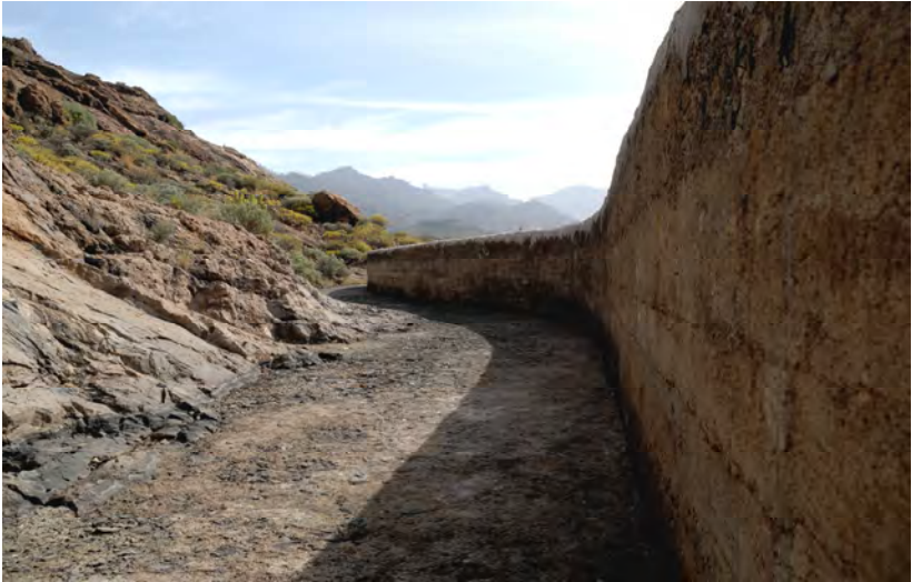
Detalle del Canal del tomadero de Majada Alta (Foto JG) (canal de roca y hormigón, terreno y obra )
