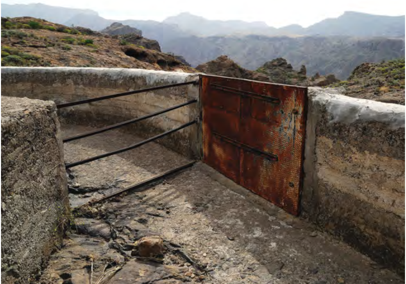
Compuerta del Canal de Majada Alta hacia la cuenca de Soria (Foto JG)
