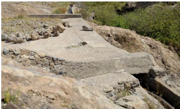
(Foto JG) El canal a su paso por la rampa de salto final de las aguas sobrantes que provienen del túnel del aliviadero de la Presa de las Niñas
