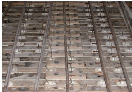
■ Detalle deteriorado del secreto del órgano mayor
