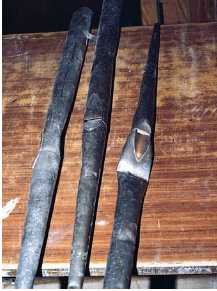
■ Detalle del deterioro de tres tubos de fachada antes de su restauración
