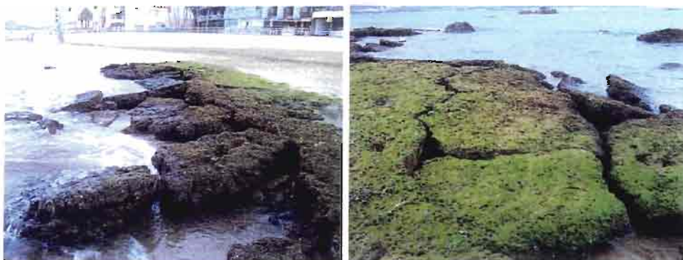
Figura 12. Detalles de la fracturación del beachrock en el arco central de la playa.
