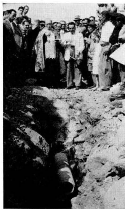
Un tramo de la tubería de conducción desde la mina de Tesén al depósito, el día de su inauguración. El diámetro de los tubos es de 15 centímetros.
