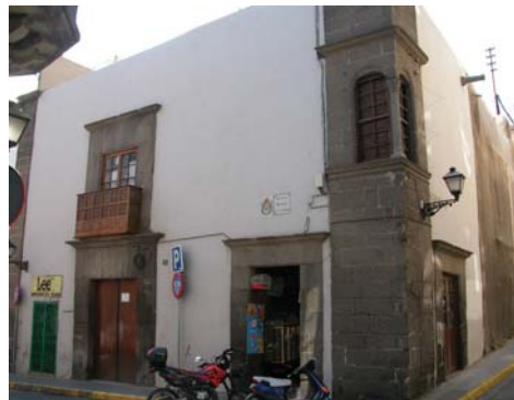
Las fotografías ilustran el estado actual de la Casa. En esta página, la fachada en esquina. A la derecha, un espacio interior apuntalado, área que ocupará la nueva biblioteca y el patio.
