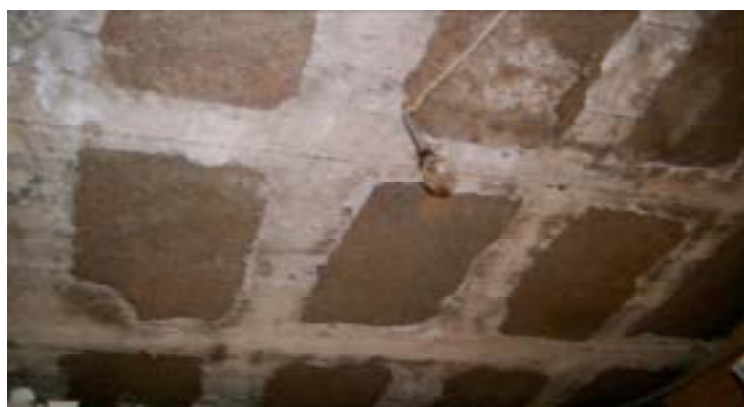
Techo de la vivienda de Dña. Encarnación Molina realizado con lajones de cantería a la manera descrita por Antonio Cedeño
