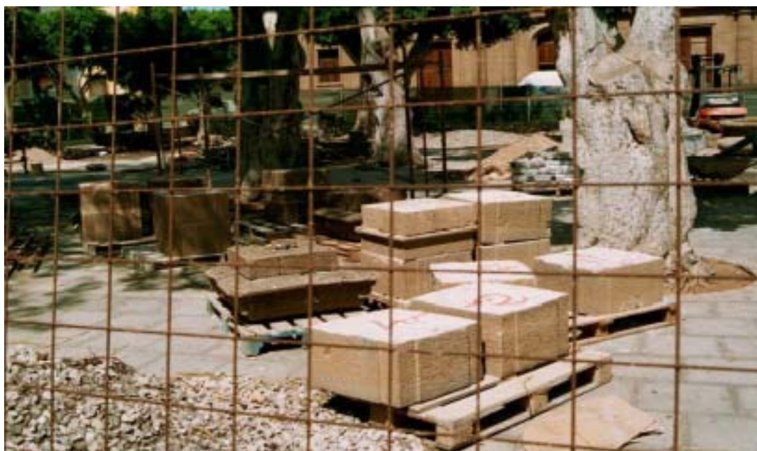
Obras de restauración en la Plaza de Gáldar Cantos obtenidos y labrados de forma mecánica
