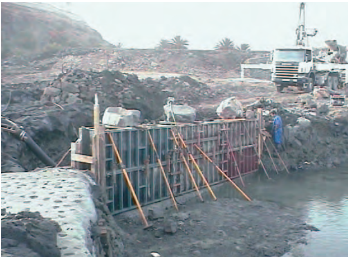
Fig. 10. Tramo de muro que sella la zona principal de filtraciones. (21-07-2005)
