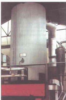
Foto 3.38.— Equipo de combustión de biomasa
