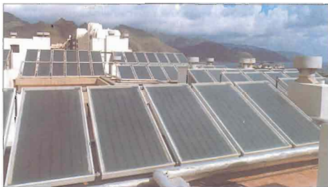
Foto 3.13— Instalación solar baja temperatura en edificio Duque Santa Elena (Tenerife)
