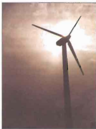
Foto 3.12.— Aerogenerador aislado en combinación con grupo diesel (Fuerteventura)
