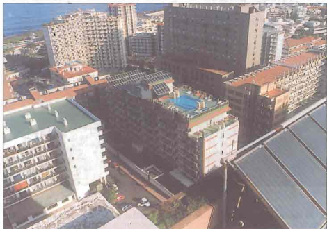
Foto n.º 1- Instalación solar para ACS edificio de apartamentos.
