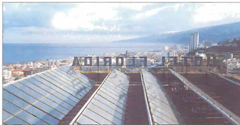
Foto 2.3.— Instalación solar en el Hotel Florida (Tenerife)
