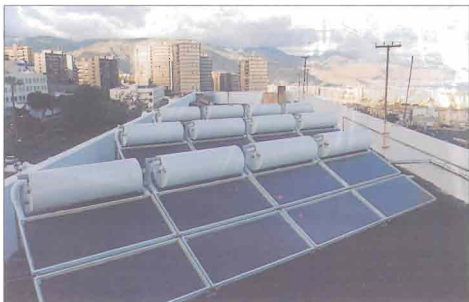
Foto 3.15. - Instalación solar baja temperatura en la Casa Cuna del Cabildo Insular de Tenerife (Tenerife)
