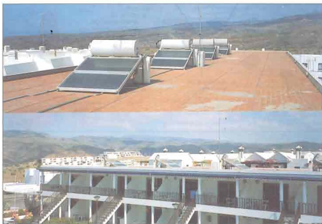
Foto n.º 1 - Instalación solar B.T. en los apartamentos SOLYMAR
