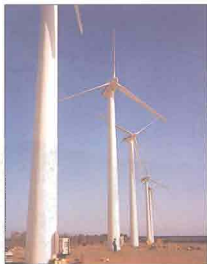
Foto 3.6.— Parque eólico Cañada del Río (Fuerteventura)
