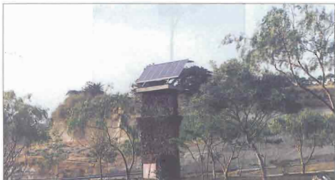
Foto n.º 1 - Energía fotovoltaica en zonas ajardinadas
