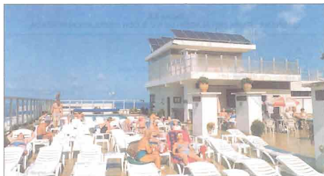
Foto 3.18.— Instalación solar baja temperatura en el Hotel Magec (Tenerife)
