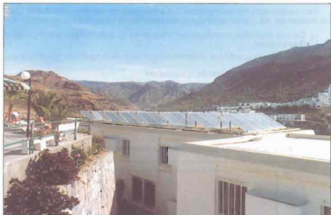
Foto 3.20.— Instalación solar Apartamentos Heliomar (Gran Canaria)
