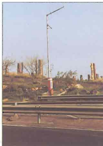
Foto 3.24.— Postes S.O.S. con energía fotovoltaica (Tenerife)
