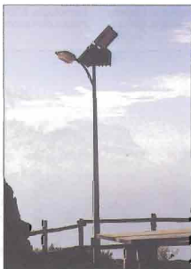
Foto n.º 1 - Farola fotovoltaica en mirador turístico
