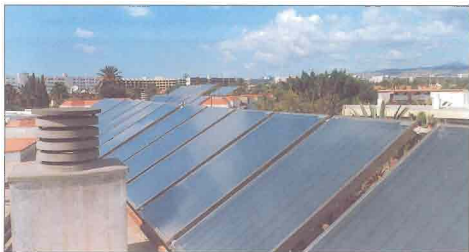
Foto 2.4.— Instalación solar bloque de apartamentos Cruz Canarias (Gran Canaria)
