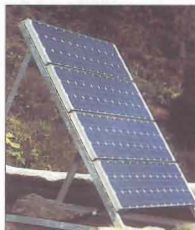
Foto 3.29.— Conjunto de paneles fotovoltaicos para aplicaciones domésticas (Gran Canaria)
