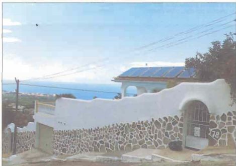
Foto n.º 1 - Instalación solar para climatización de piscina
