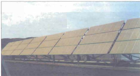
Foto n.º 1 - Central fotovoltaica de La Graciosa
