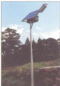
Foto 3.23.— Aluminado público fotovoltaico (La Palma)
