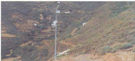
Foto 2.5.— Iluminación fotovoltaica en el Barranco de Guayadeque (Gran Canaria)
