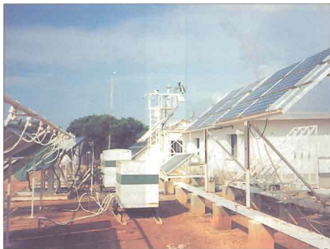
Foto 3.27.— Electrificación faro Anaga (Tenerife)
