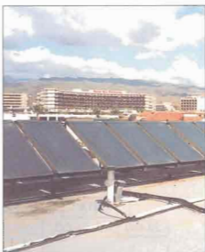
Foto 4.2.— Sistema de captación en los apartamentos Bogotá (Gran Canaria)
