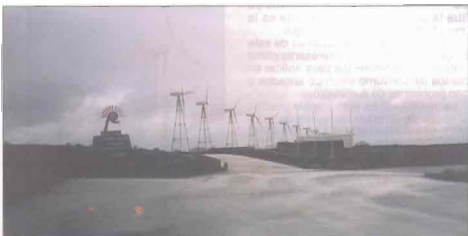
Foto n.º 1- Parque eólico de Los Valles
