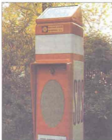
Foto n.º 1 - Poste de S.O.S. con panel en el propio poste
