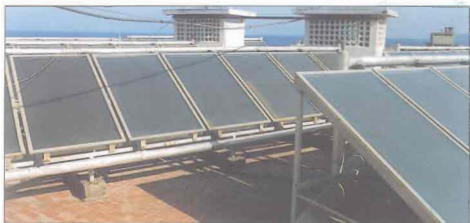
Foto 3.16.— Subsistema colector instalación hotel Orotava Garden (Tenerife)
