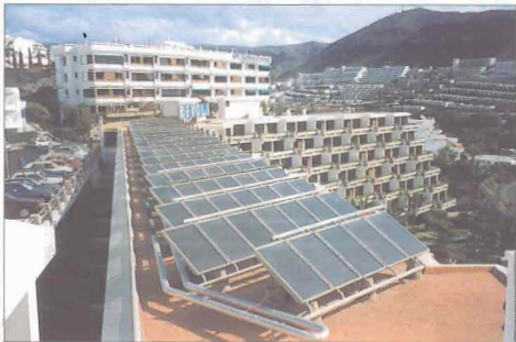
Foto n.º 1 - Instalación Solar B.T. en Apartamentos Revoli
