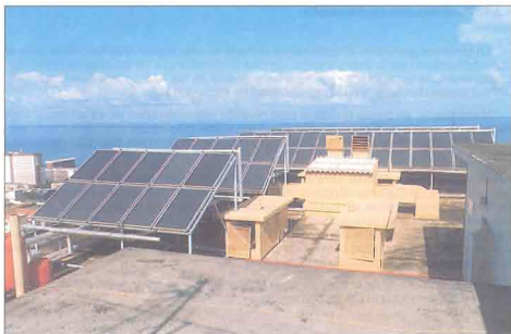
Foto 3.14— Instalación solar baja temperatur en hotel Tigala (Tenerife)
