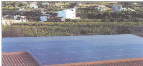
Foto n.º 1- Instalación fotovoltaica del centro escolar de Los Llanos de Aridane
