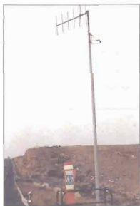
Foto n.º 2 - Poste de S.O.S. con panel en la antena
