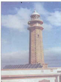
Foto n.º 1 - Instalación fotovoltaica del faro de Orchilla (El Hierro)
