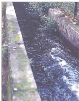
Foto 3.40. Canal de derivación. Central hidroeléctrica el Mulato (La Palma)
