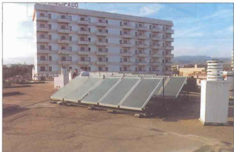
Foto 3.21.— Instalación solar Apartamentos Maba Playa (Gran Canaria)
