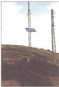
Foto 3.26.— Electrificación fotovoltaica de sistemas de toma de datos
