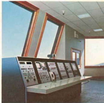
Consola de control.
