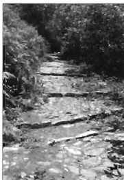
Foto 18. Las canalizaciones tienen como función principal evacuar el agua de escorrentía con el fin de que no destruya el firme de los caminos. Camino de Las Vueltas de Acero, Moya.
