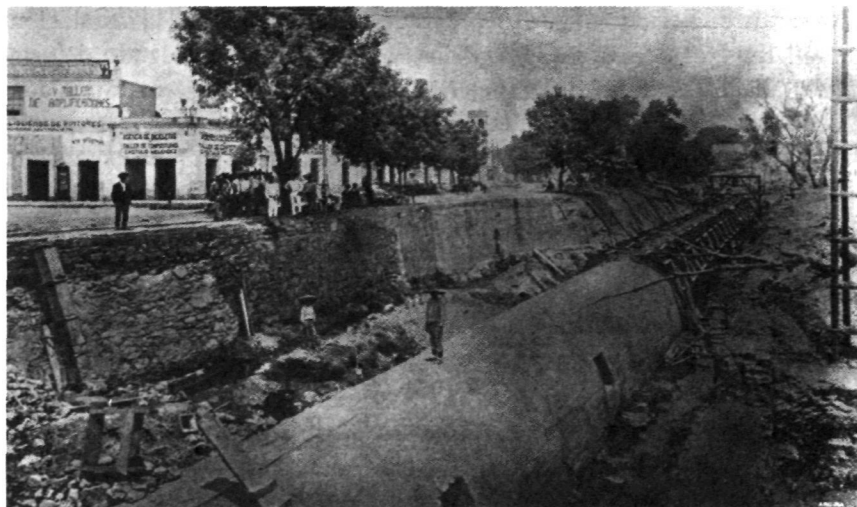
Obras de embovedamiento del Río San Juan de Dios a principios del siglo xx.
