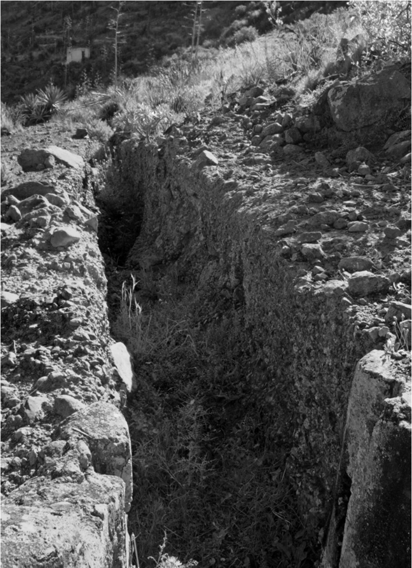
Detalle de la acequia en rocas que liga el Túnel de San Lorenzo con el embalse (Foto J. Palomo)
