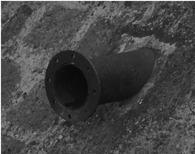
Detalle de una de las tuberías (Foto Jaime González)
