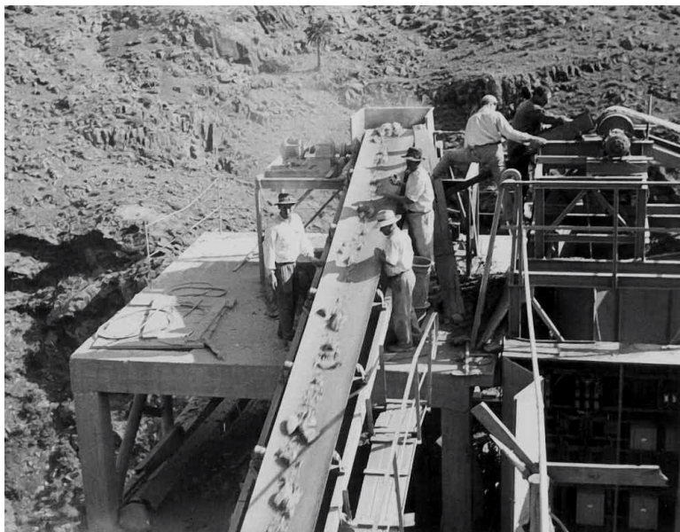
Obreros trabajando con esmero en la estación de machaqueo de áridos (Foto cedida por la familia de don Fermín Monzón)
