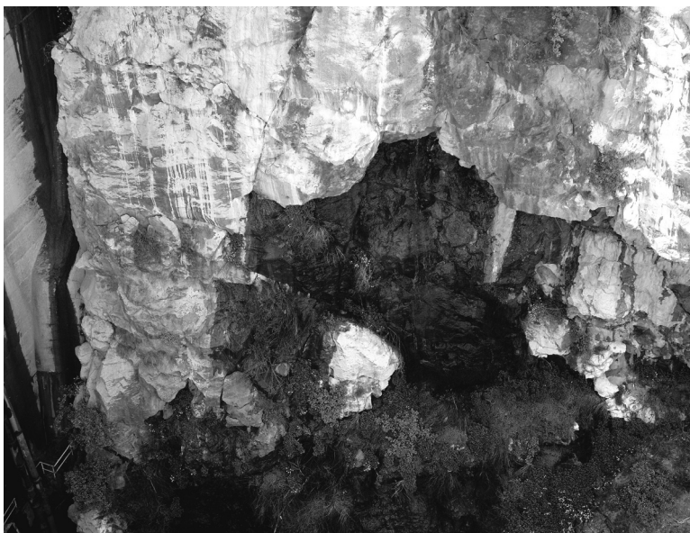
Importantes filtraciones por el risco con la carga de agua en 86 metros 27 de marzo de 2010 – Ladera izquierda (Foto Jaime González)
