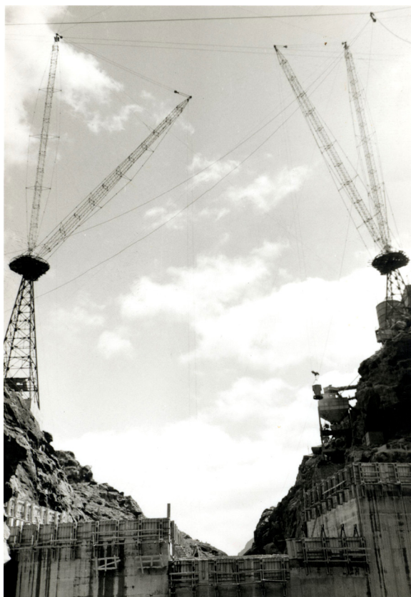
Grúas Derrick venteadas (Foto Servicio Hidráulico LP)
