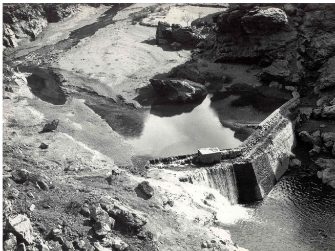
Depósito provisional de agua para la obra
