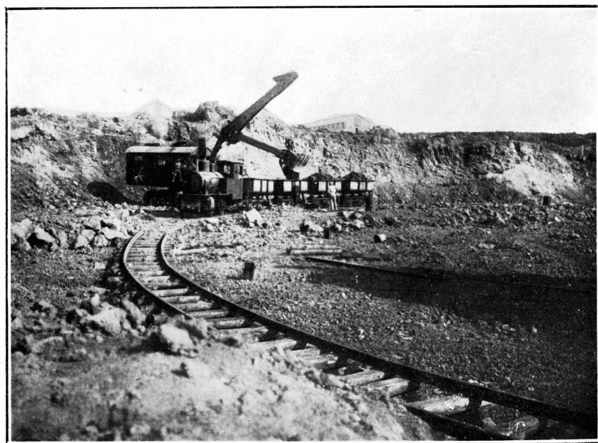
VI.—La pala «Bucyrus» cargando un tren en la zona de extracción en enero de 1928.
