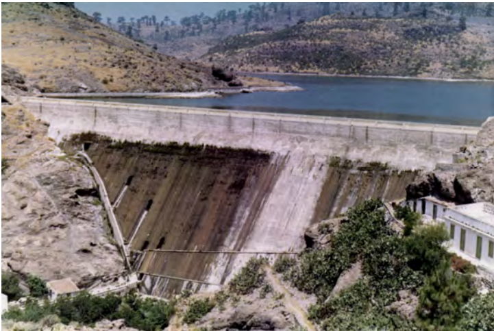
Se observa la línea de filtraciones a través del muro (Foto Informe de 1972)
