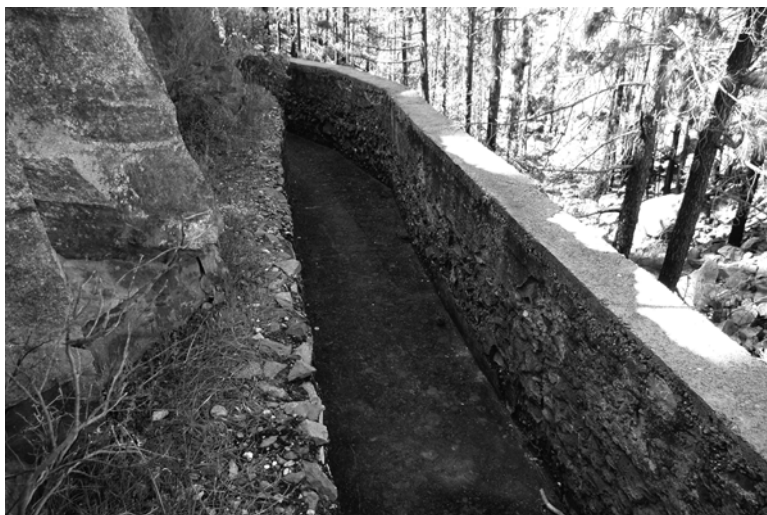
Canal de 1,50 por 1,50 del Tomadero del Mulato
