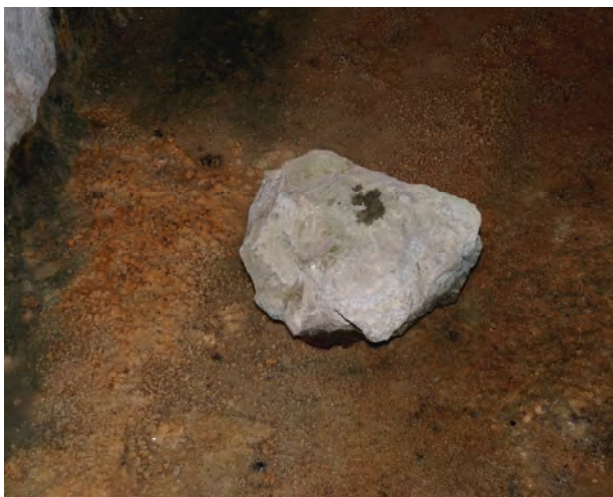
Mampuesto desprendido del muro (Foto JG) (interior de una de las galerías transversales)
