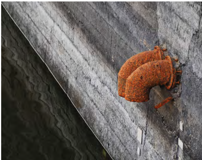
Tuberías de las tomas de agua de la Galería 1 (Foto JG)
