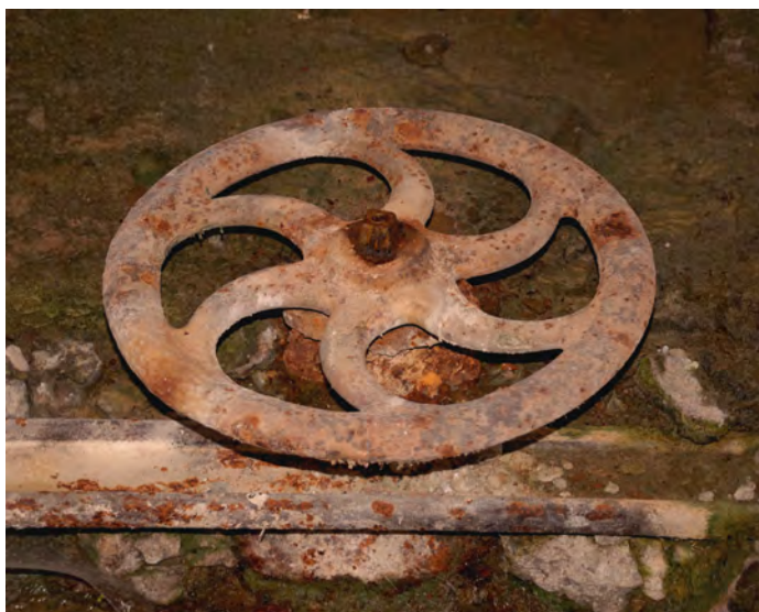
Llave de paso antigua de la Presa de las Niñas
