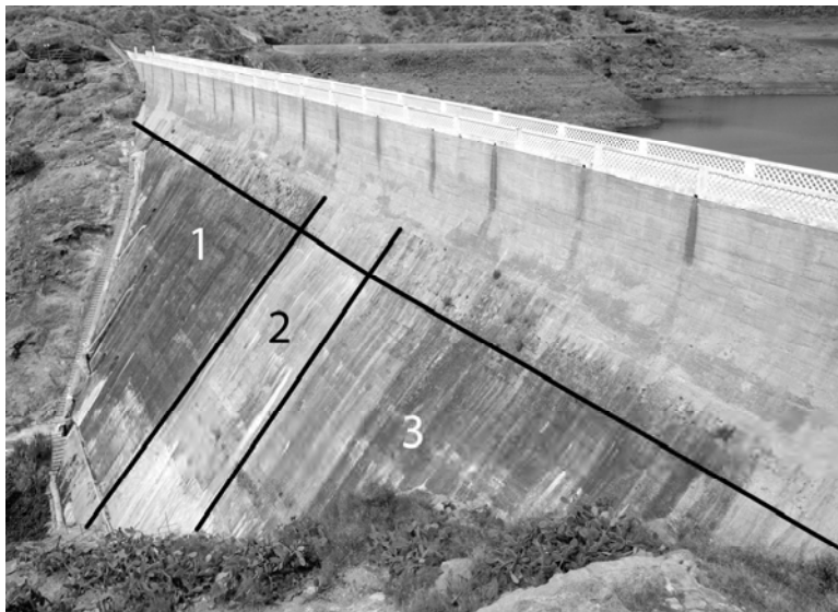
Sectores del muro según las filtraciones ocurridas desde 1958
