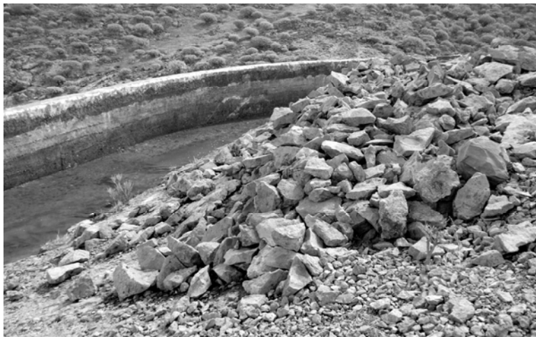
Depósito de rocas producto de la construcción del Canal del Tomadero de Majada Alta (Foto Jaime González)
