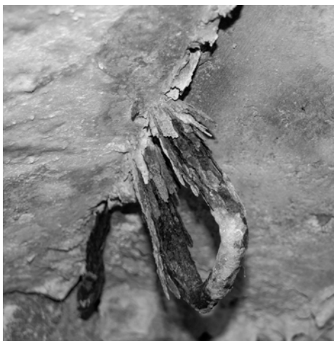
Gancho del techo encima del pozo
