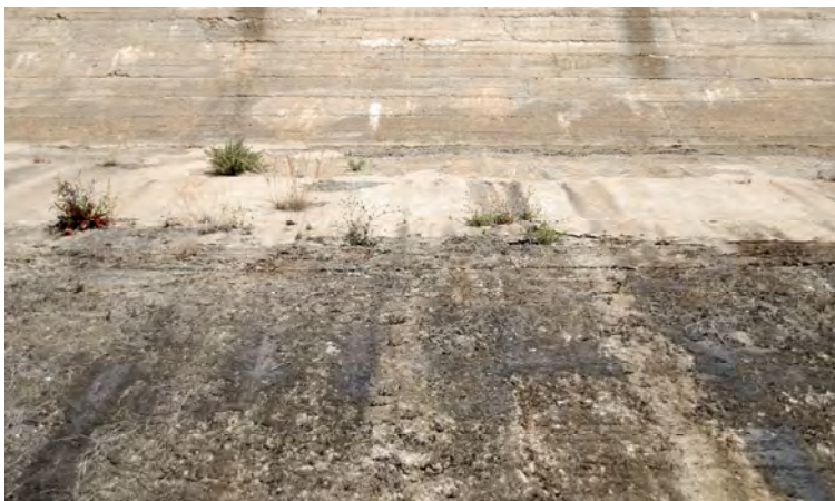
Detalle del paramento del talud aguas abajo de la presa (Foto JG)
