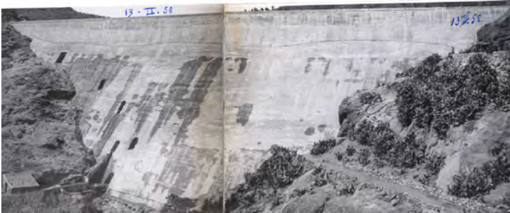
Se observa la línea de filtraciones (13 – II - 1958) (Foto Comunidad Presa de las Cuevas de las Niñas)
