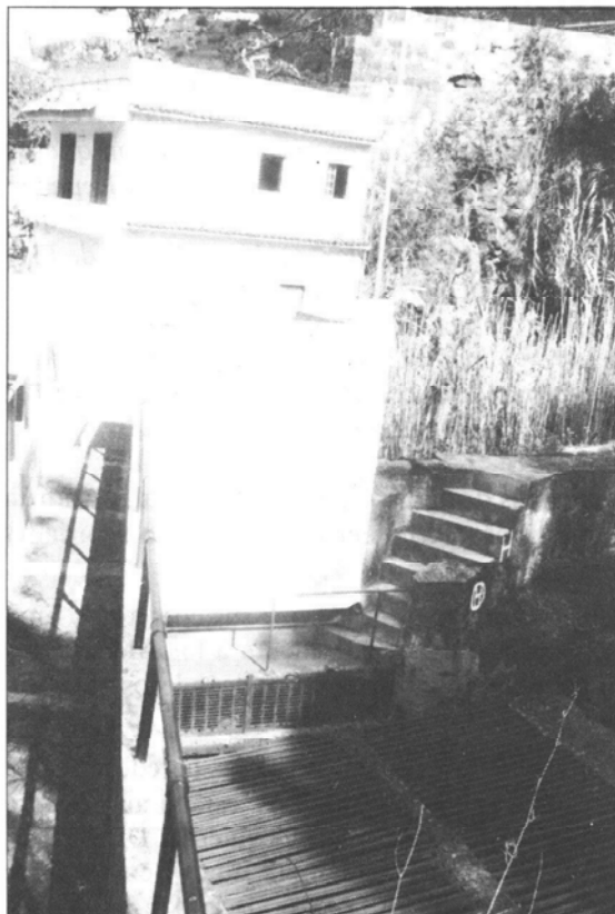
Tomadero de las Aguas pluviales de los barrancos de “La Virgen” y “Rapador”, Firgas.
