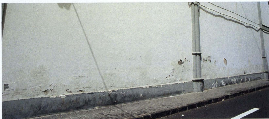
Materiales no adecuados (enfoscados de cemento y pinturas plásticas)
