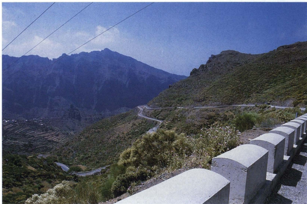
Acabado de elementos de borde inadecuados (pintura)
