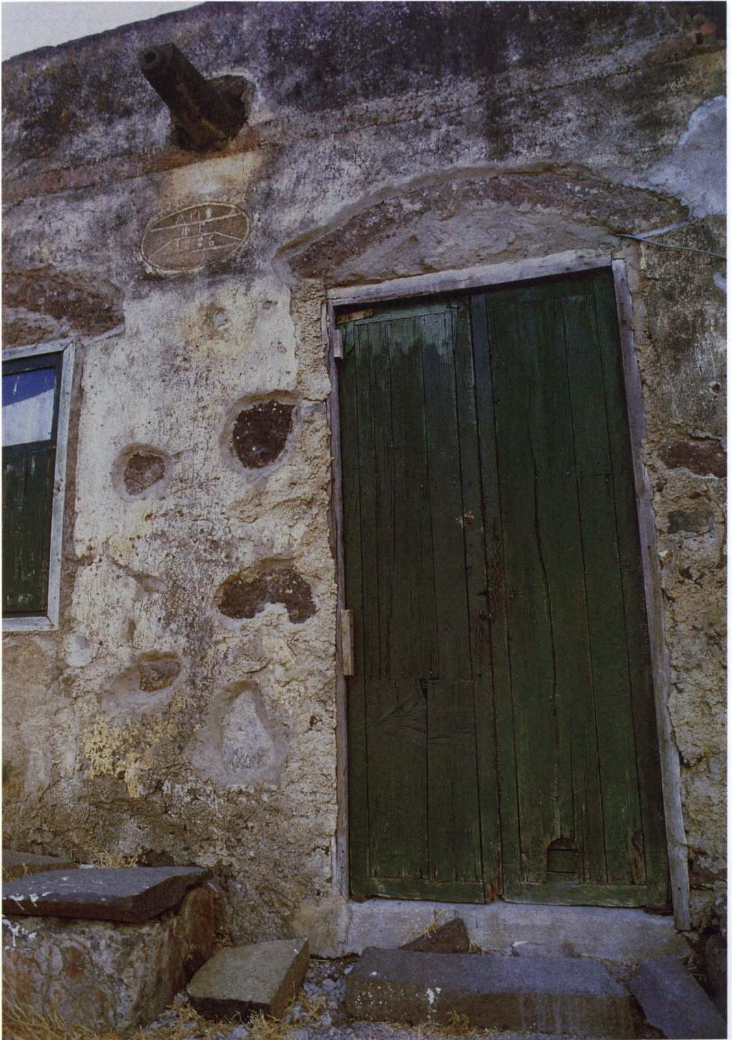
Detalle de carpintería
