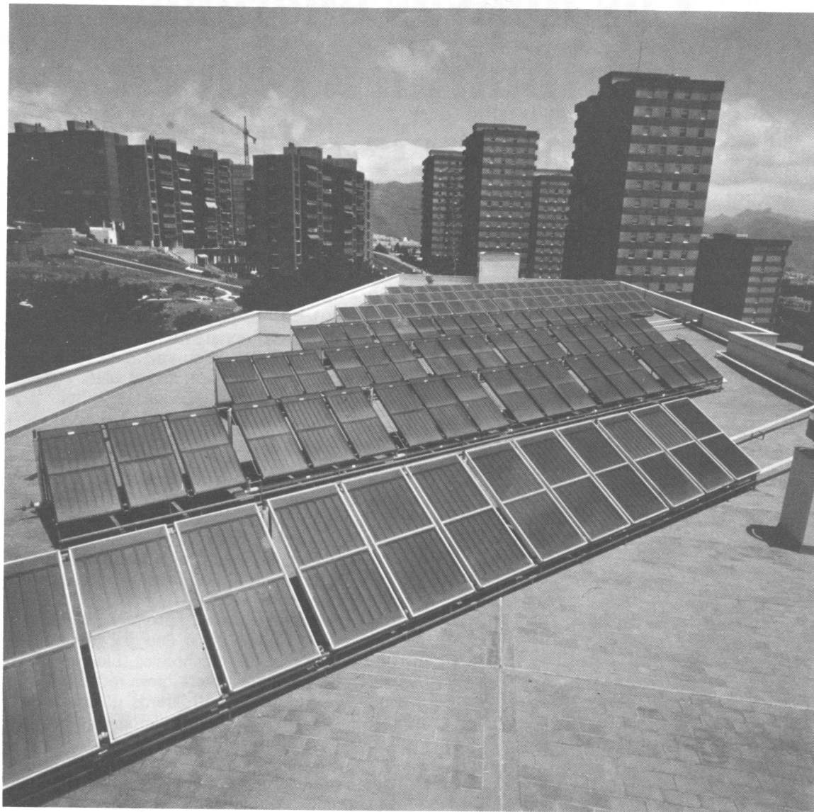
Vista de los colectores instalados en el Hogar de la Sagrada Familia de Santa Cruz de Tenerife.
