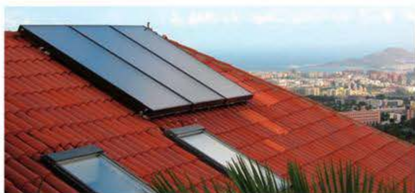
Colector solar integrado en techo
