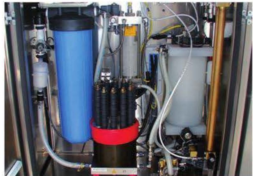
Interior de un electrolizador
