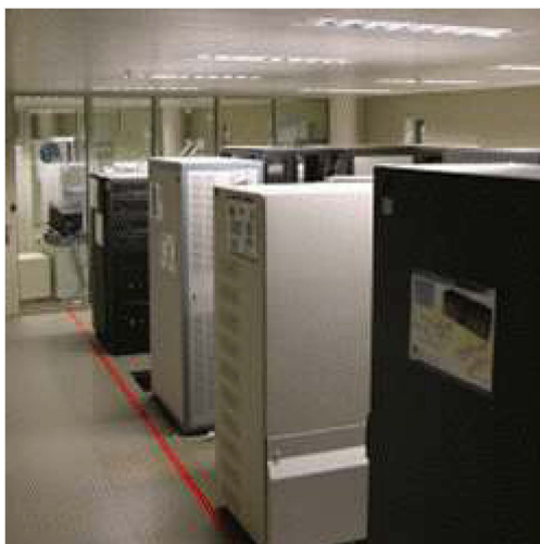
La "sala de máquinas" del CESGA.
