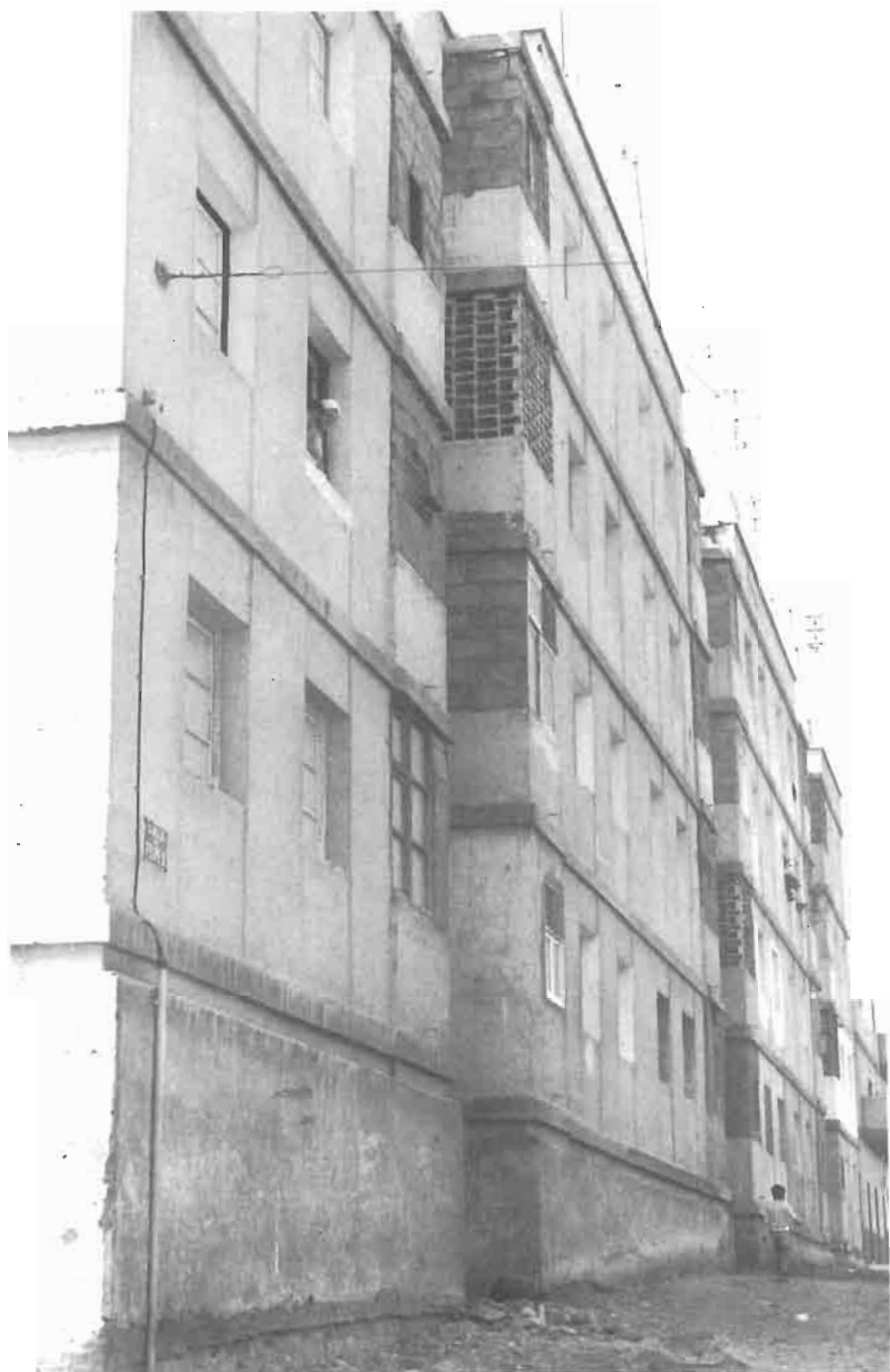
13.— Bloques de "viviendas sociales". Obsérvese el avanzado estado de deterioro de las mismas.
