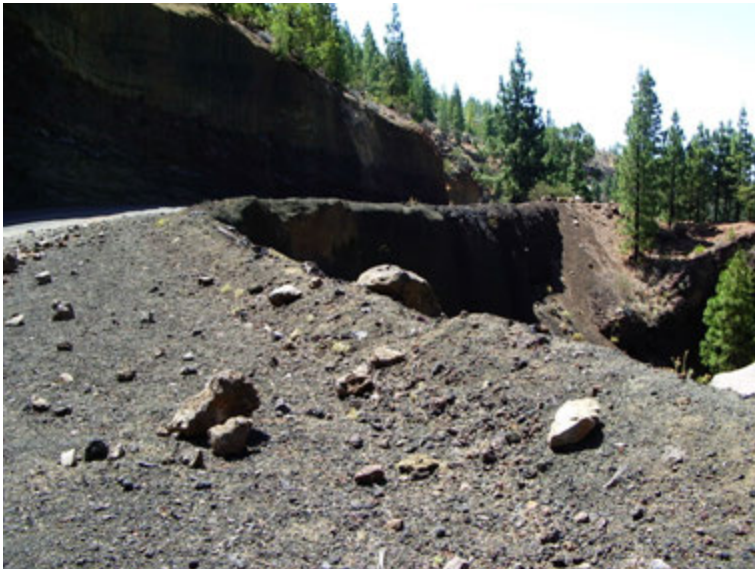
Figura 5.11:Detalle de pista sin peralte, ni infraestructuras para recogida de agua.
