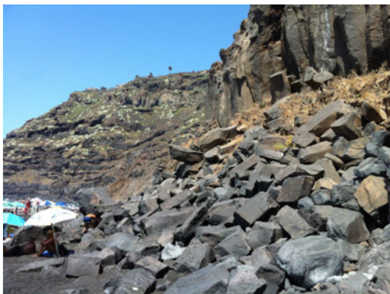
Figura 15.1: Desprendimientos por vuelco de estratos en el frente de una colada basáltica con diaclasado de retracción preferentemente vertical, playa del Ancón, Tenerife.
