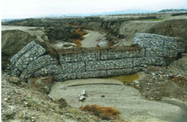
Figura 11.20: Ruina de un dique de gaviones a causa de la tubificación lateral: el agua, al ser forzada a alcanzar un gradiente hidráulico demasiado elevado, se infiltró en los márgenes descalzando la estructura (Foto: I. Pérez-Soba).
