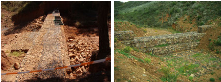
Figura 11.22: Diques de gaviones: a la izquierda, en construcción (se aprecian las jaulas vacías, y se ven los encofrados metálicos que servirán para su relleno); a la derecha, un dique concluido (Fotos: I. Pérez-Soba).
