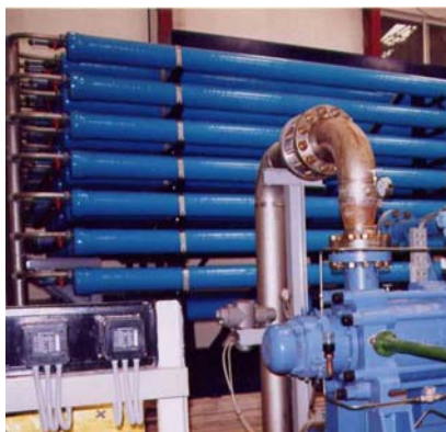
TUBOS DE MEMBRANAS DE UNA DESALADORA
