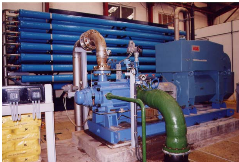
PLANTA DESALADORA PÚBLICA, CONSTRUIDA POR CADAGUA
