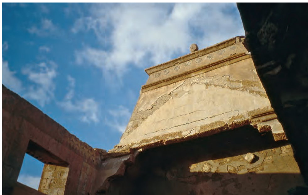
Casa Fuerte. Campana de la cocina. Adeje
