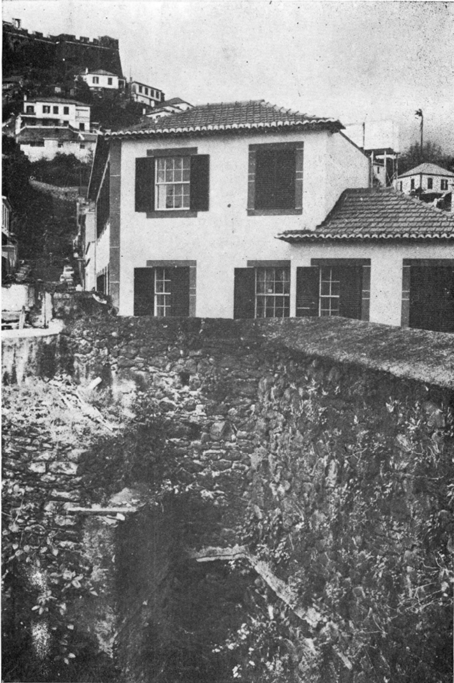
Trozo de la vieja muralla, entre rua da Carreira y rua da Alegria
