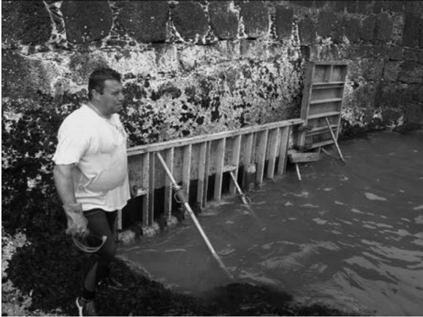
Fig. 5. Pablo Gallo Reverón durante unas obras por 2010 en el muelle de Puerto de la Cruz, en las que se rellenó una gran oquedad en el dique del este.
