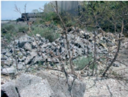
Restos de muro
