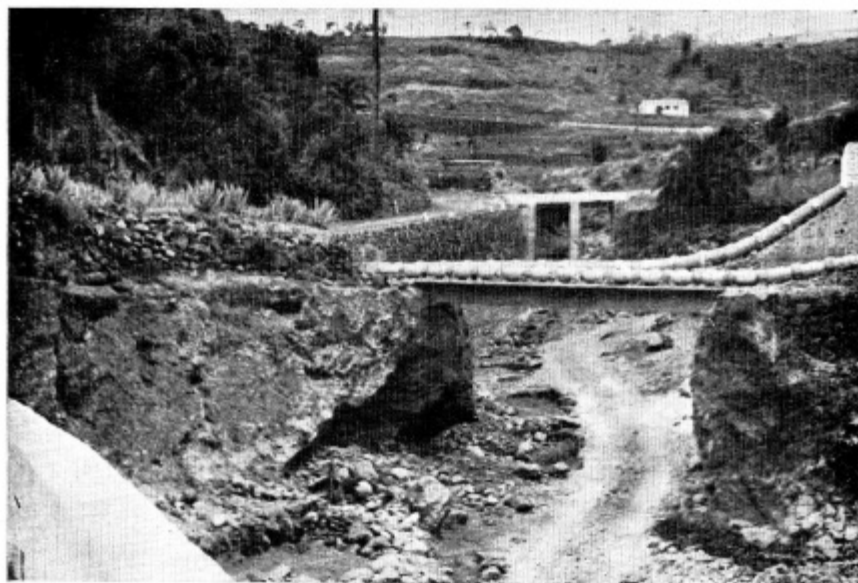
Tuberías de hormigón armado.
