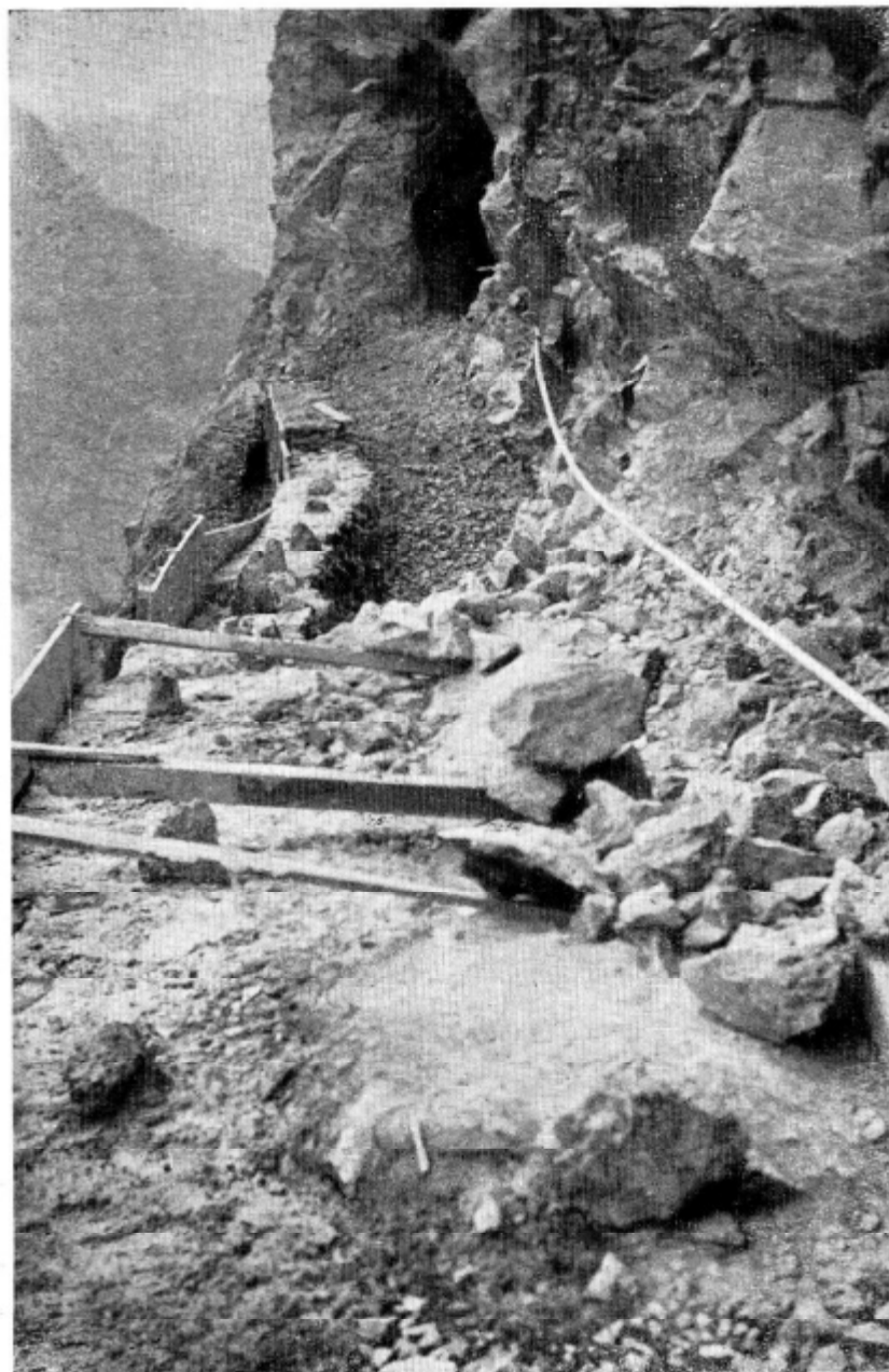
Construcción del canal de La Lumbre en el sur de Gran Canaria.
