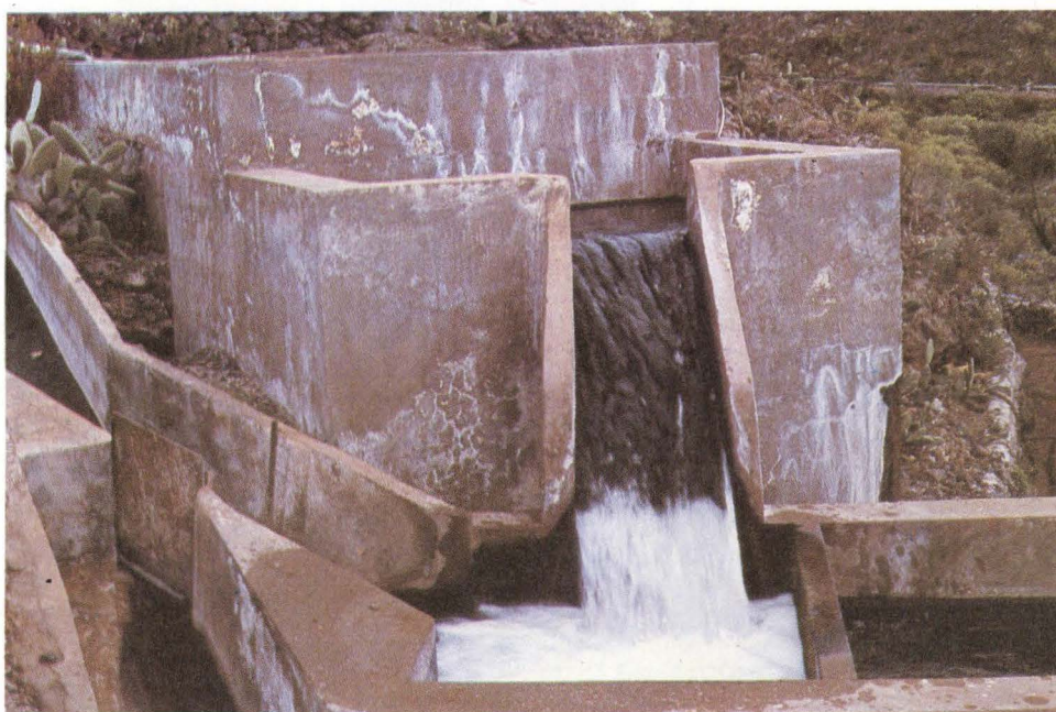
f. 17.—Vista de una tanqueta de distribución y reparto, usual en galerías
