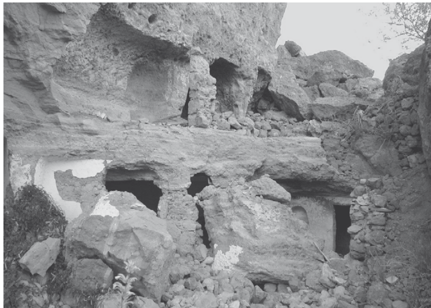
Nº 7.- Desprendimientos en el sector norte del poblado troglodita de Risco Caído.
