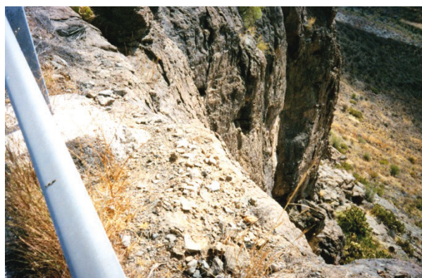
Figura 2. Detalle de la proximidad del borde de la plataforma existente a la coronación del talud vertical, dificultando las posibilidades de ampliación de la sección transversal.
