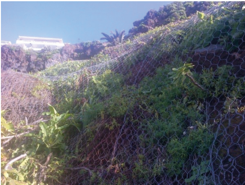
Figura 8. Vista de la malla de triple torsión reforzada con anclajes y cables.
