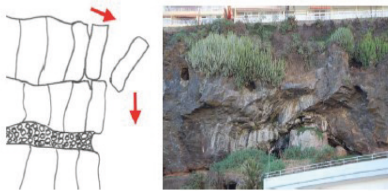
Figura 2. Inestabilidad por desprendimiento de bloques.
