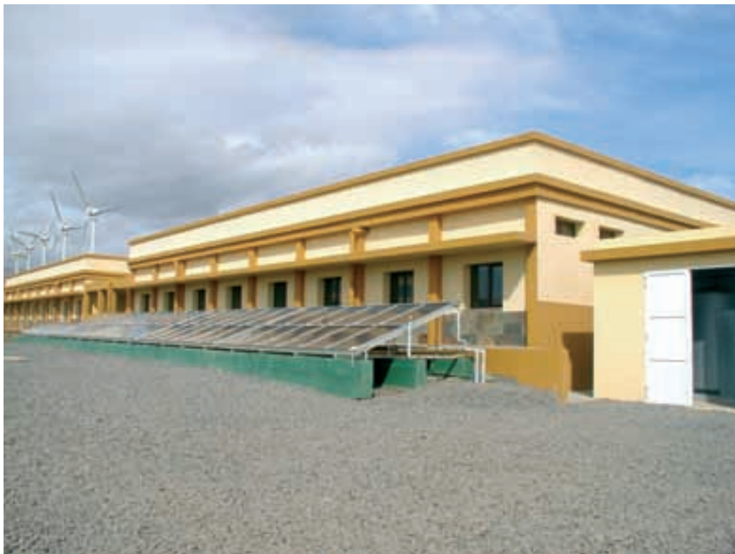
Instalación de frío solar
