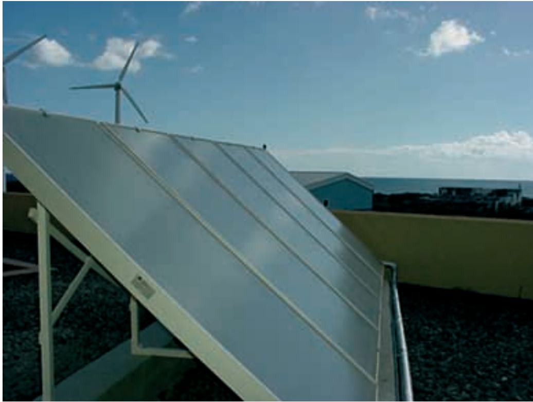
Instalación solar térmica
