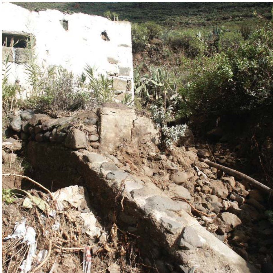
Caja de Reparto Bco. Guayadeque
