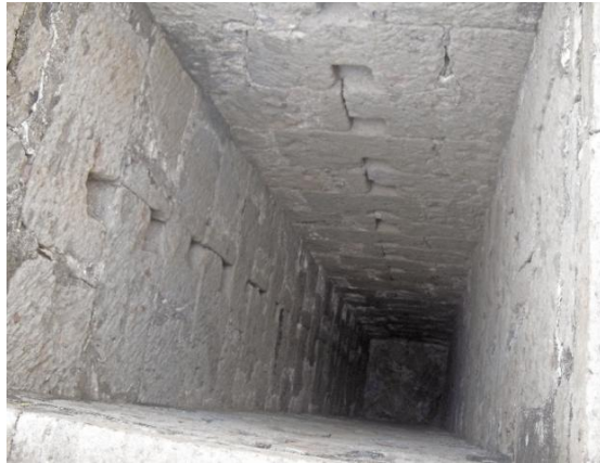
Interior de la Campana 1 de la Mina de Zamora , extraordinario pozo de ventilación forrado con cantería noble de la zona, de planta cuadrangular. | MIGUEL ÁNGEL VEGA. COLECTIVO TYLDET.
