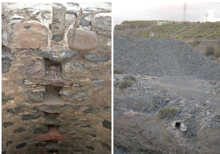
Izquierda: detalle del interior de una de las campanas donde se observan los huecos (mechinales) para bajar a la misma (2004).
