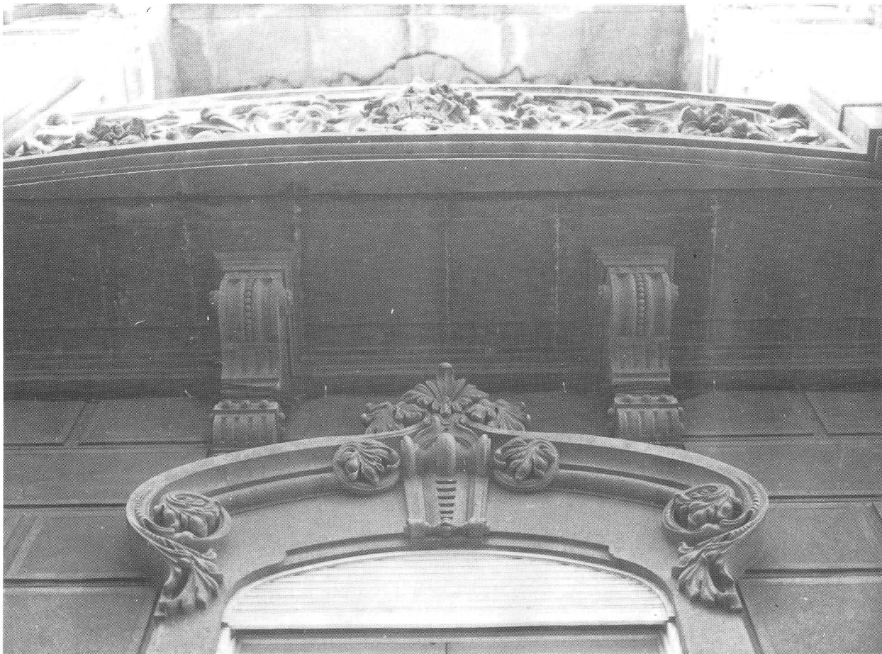
184. Detalle dintel de la ventana de planta baja. Travieso, 24. Fernando Navarro. Foto: Andrés Solana.
