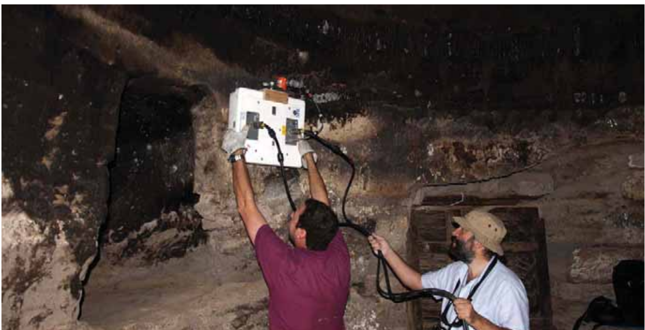
Figura 4.b.9. La relativa fragilidad de las viejas formaciones piroclásticas (tobas volcánicas) que albergan el patrimonio troglodita, obligan a un monitoreo constante de sus condiciones ambientales y estructurales, para actuar en consecuencia. En la imagen, trabajos en la cueva de Risco Caído. © Cabildo de Gran Canaria
