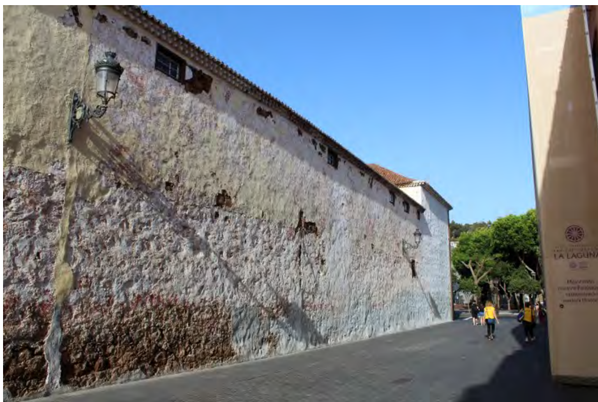
Paramento del convento de Santa Catalina por la calle de La Carrera-Obispo Rey Redondo. En él se observan los distintos enfoscados del edificio. (Foto: elaboración propia).
