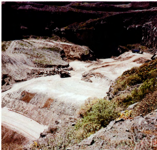
Fase II: cubrimiento de residuos. Vertedero de El Salto del Negro (Gran Canaria).
