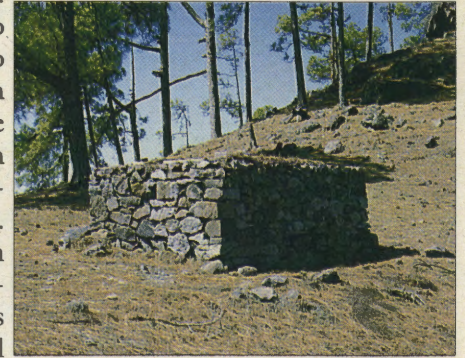
Entre las actuaciones de conservación en el medio natural se encuentra la instalación de bebederos artificiales, que pallan en los periodos estivales la escasez de agua. (4)
