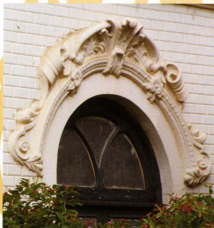
Dintel de casa modernista
