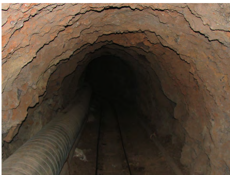
Figura 5 ; sección de una galería en el Sur de la isla de Tenerife, se puede observar la falta de elementos para sostenimiento de la sección, habitual en perforaciones en terrenos volcánicos , salvo que nos encontremos en zonas de fanglomerado (superficie de un gran deslizamiento), materiales más fluidos como las pumitas, caída de prismas basálticos, coladas de piroclastos , etc....
