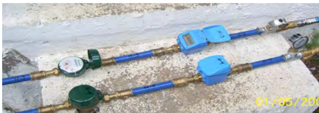
Figura 1; Tren de medida. La carcasa azul corresponde al caudalímetro digital, la carcasa verde oscuro pertenece al caudalímetro de facturación y el manómetro se distingue por la carcasa metálica. (Militello, 2009)
