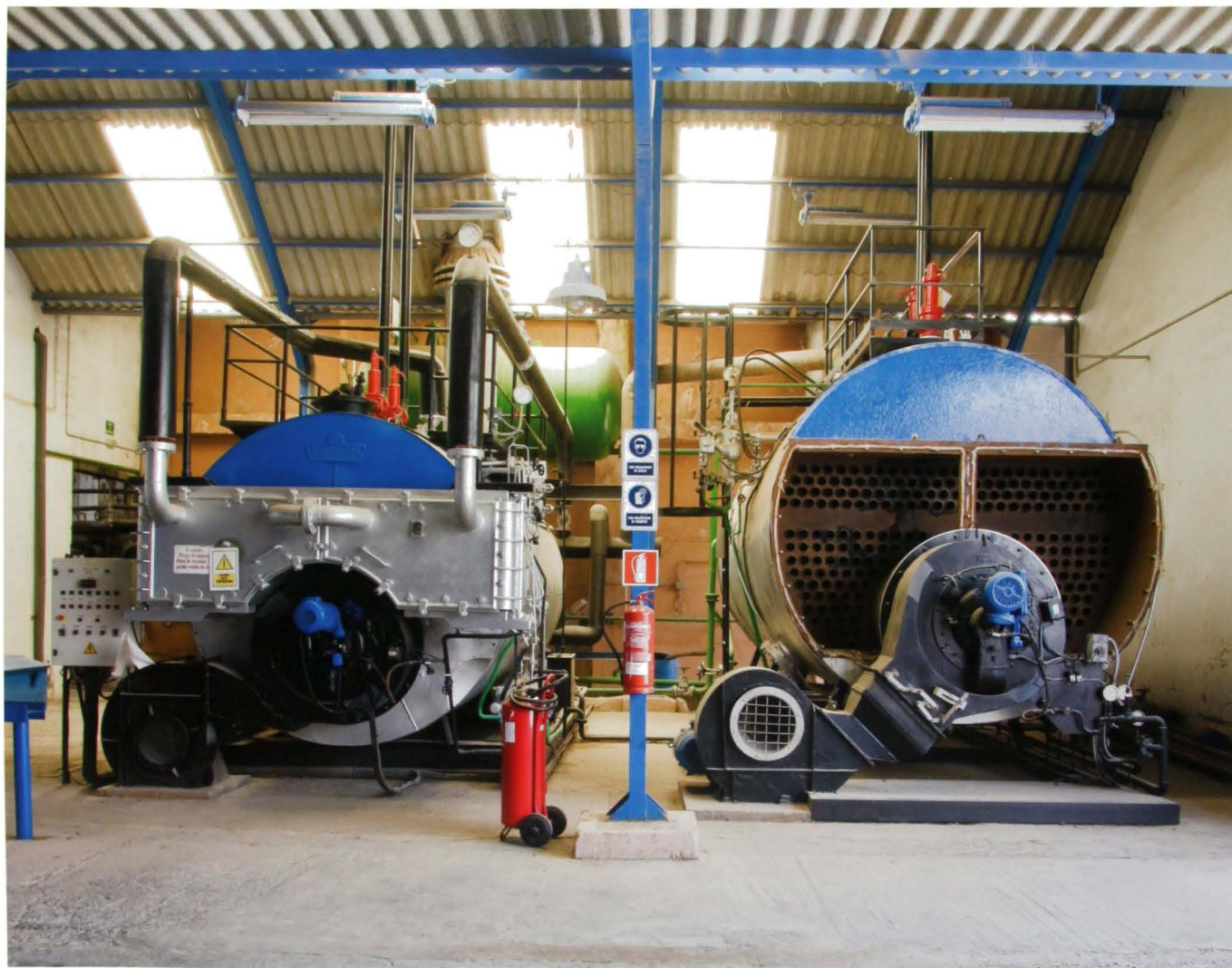
Calderas de Artemi. 2010. (Fondo documental de Destilerías Arehucas S.A.).
