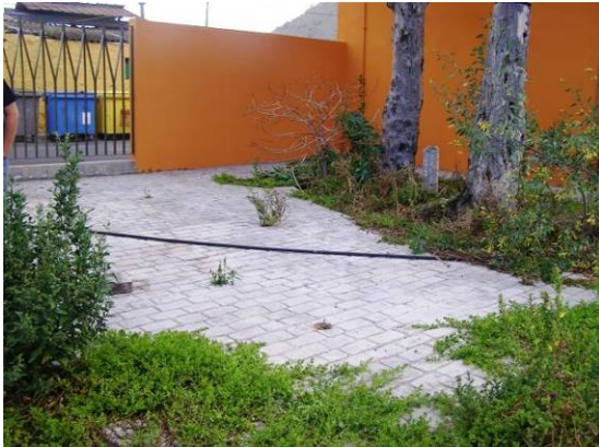
Losa de hormigón impreso, incompatible con el desarrollo radicular.
