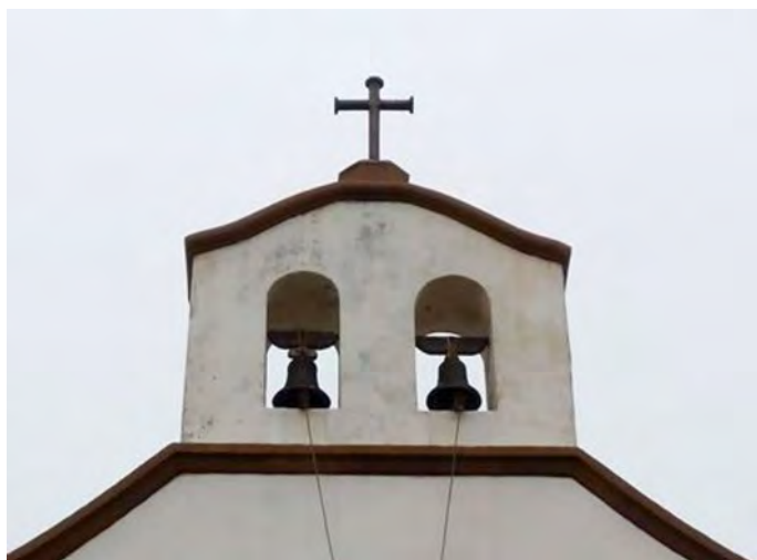
Foto 6. Anónimo. Espadaña con dos campanas (inicios del siglo xvi, reconstrucción de la primera década del siglo xx). Ermita de San Antonio de Padua. Garafía, España (foto del autor).
