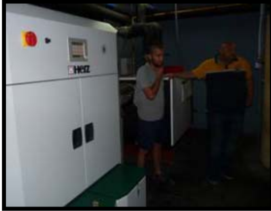
Caldera de pellets de piscina pública
